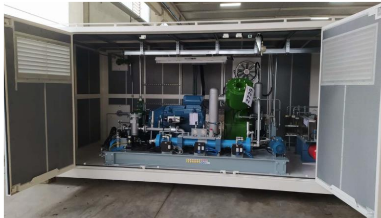
pav. 3 Kompresoriaus konteineris
