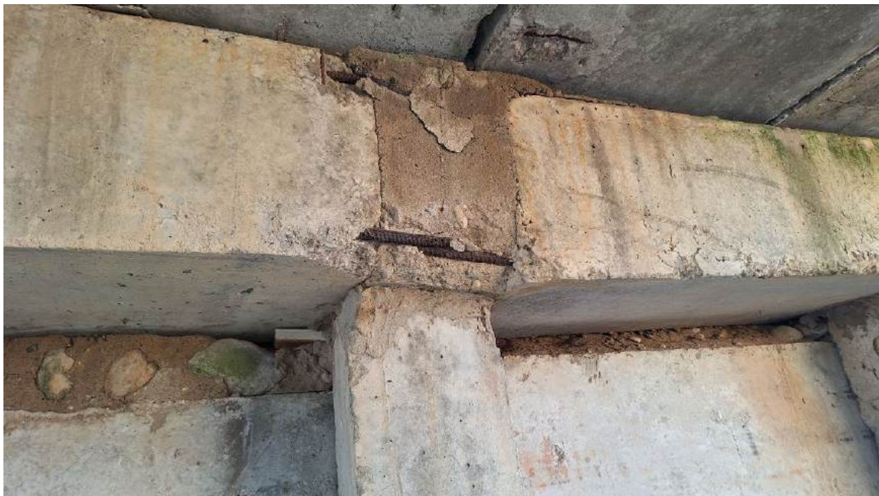
Pav. 10. Defektai krantinėse atramos ir atraminėse plokštėse
