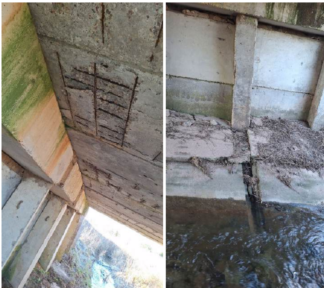
Pav. 8 Porėtas betonas tilto perdangoje, pasėdusio atraminės sienos plokštės
