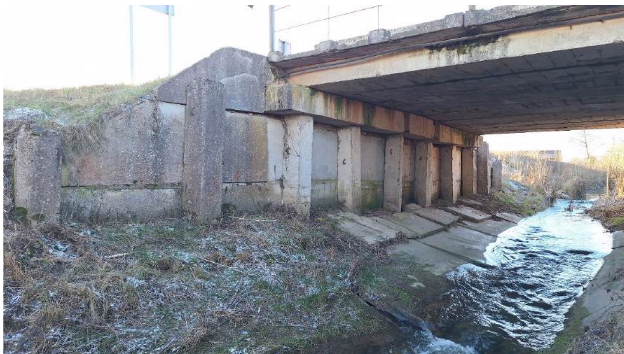
Pav. 9. Defektai krantinėse atramose ir atraminėse plokštėse
