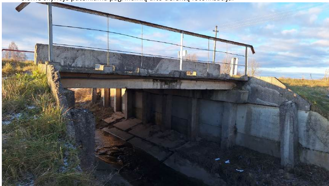
Pav. 5. Tilto fasadas, surūdiję turėklai ir pažeidimai betono konstrukcijoje
