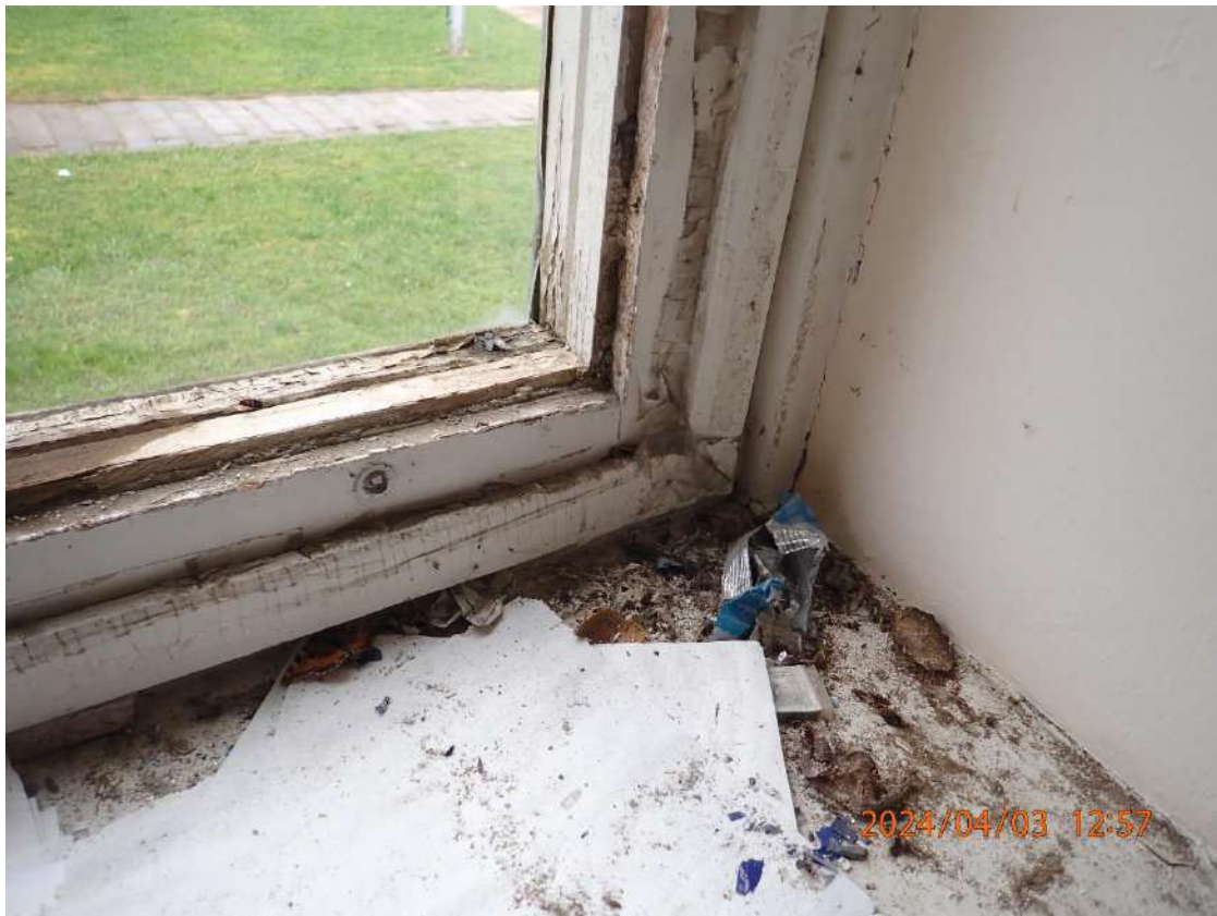
Nuotrauka Nr. 5. Puvėsio pažeista langų konstrukcija
