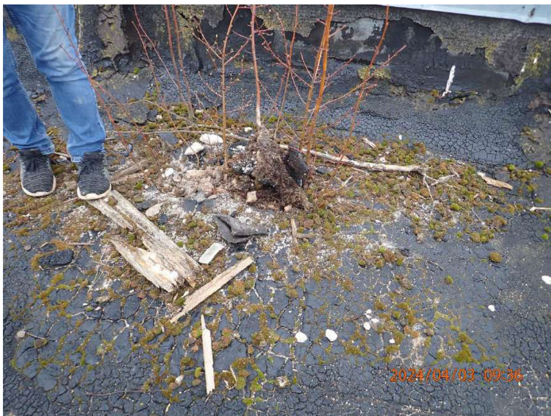
Nuotrauka Nr. 18. Suirusi stogo danga („krokodilo oda“), medžiai suleidę šaknis į pasluoksnius po bitumine danga
